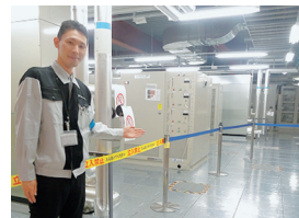
初公開の電源室
